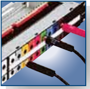
Patchkabel und Farbmarkierungen
